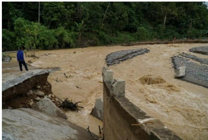
Gambar 1.2 Kondisi jalan yang terkena banjir bandang (Sumber : Kompas.id)
