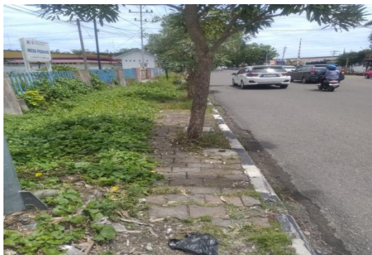
Gambar 4.2 Trotoar Ditumbuhi Rumput Liar
