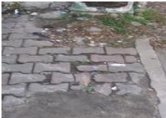
Gambar 4.1 Rusaknya Permukaan Trotoar
